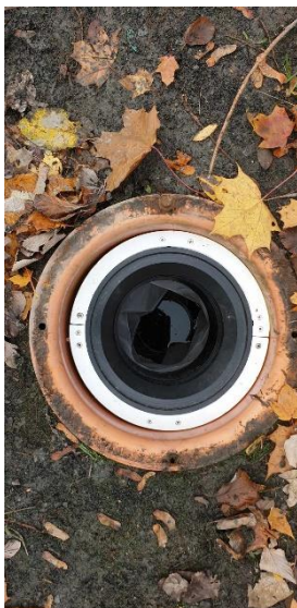
Granulatfälla monterad på Råstasjöns IP
