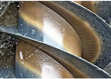
Del av en arkimedes-skruv på Nykvarnsverket, Tekniska verken i Linköping AB. Foto: Staffan Ågren/Naturvårdsverket.
