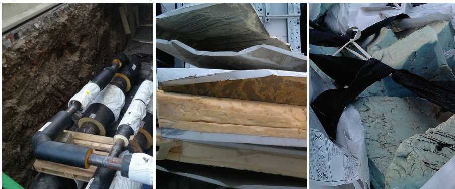
Isolering av fjärrvärmerör kan innehålla CFC, här PUR (polyuretan).
