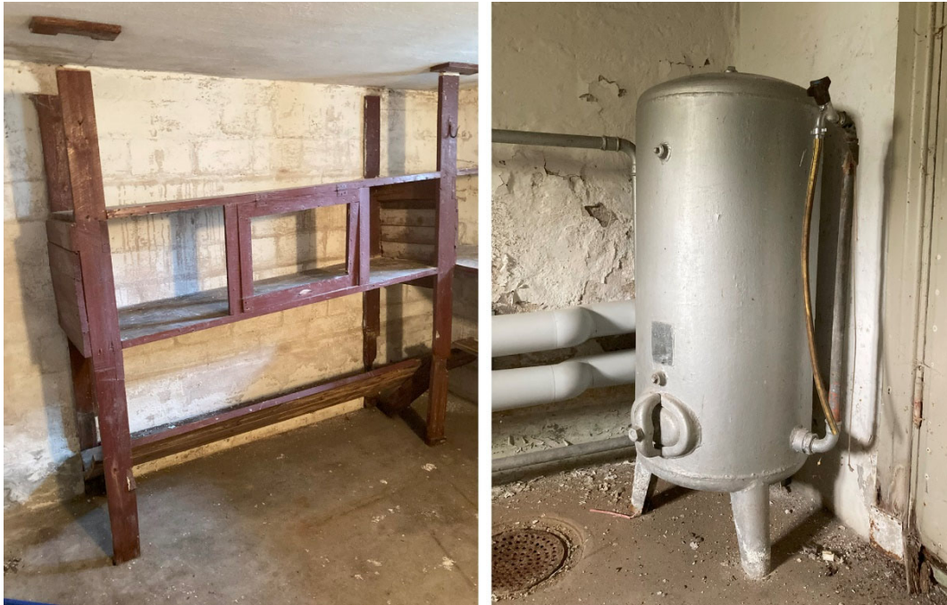
Bilden till vänster. Källarutrymme med träinredning. Bilden till höger. Hydrofor och golvbrunn. Spår av översvämning på väggarna.
