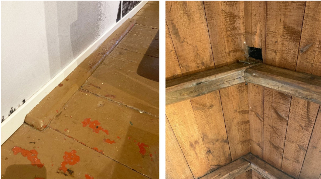
Bilden till vänster. Den ursprungliga ingångens fasade tröskel. Bilden till höger. Hål i bräddtaket för ursprunglig ventilationshuv i Fotogenboden.
