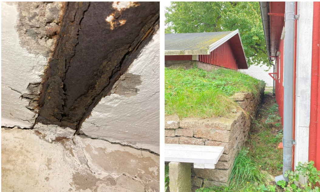
Bilden till vänster. Bärande I-balk i betongvalvet, kraftig korrosion. Bilden till höger. Stödmur av kalksten runt om byggnaden, delvis omlagd.
