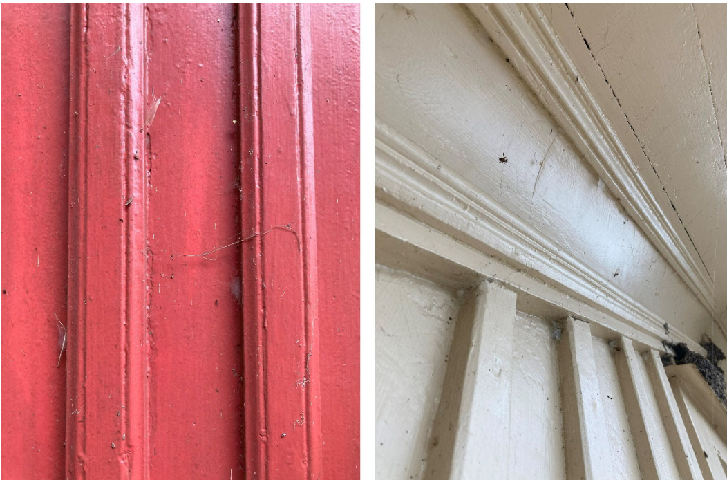
Bild till vänster. De av Lotsverkets beställda profilerade locklisterna, ännu kvar på Förrådet/uthusets norra fasad (de sista kvarvarande original läkten på fyrplatsen). Bild till höger. Bark & Warburg AB:s standardlistverk. Gesimslist på Fyrvaktarbostad uppförd 1872. Ursprungligen rödfärgade fasader och takfot, nu Beige linoljefärg.
