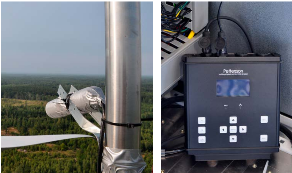
Figur B 4.2. Ultraljudsmikrofon monterad på ett stag på navhuset och förbunden med en ultraljudsdetektor inne i tornet via en kabel.
