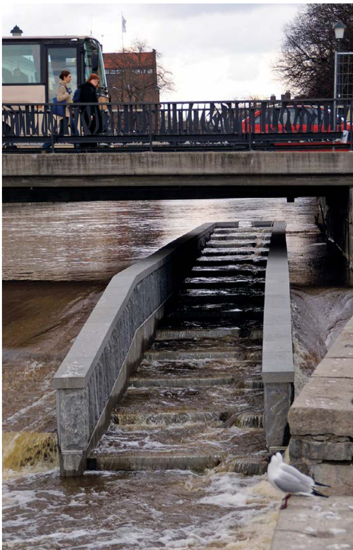
Bild 6. Tekniska fiskväg, en så kallad slitsränna, vid Islandsfallet i Fyrisån, Uppsala. Fiskvägen passeras av mängder av arter och storlekar av fisk och mängden fisk uppströms har ökat markant.
